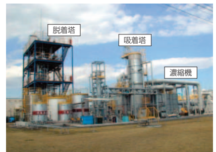
【溶剤回収装置】
