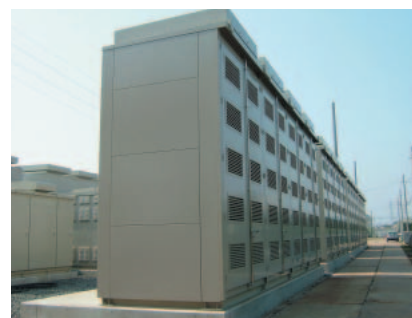
【オートモティブシステムグループに設置したNAS電池】
