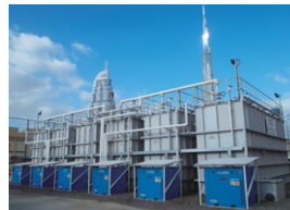
水再生プラント (UAEドバイ) ※
