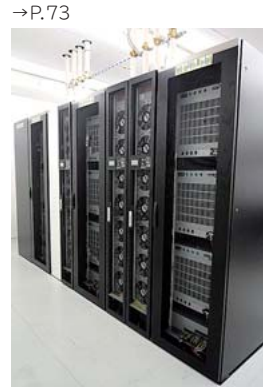
モジュール型データセンタ
