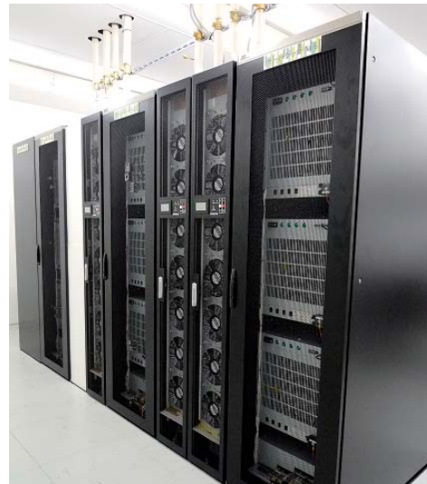
モジュール型データセンタ
