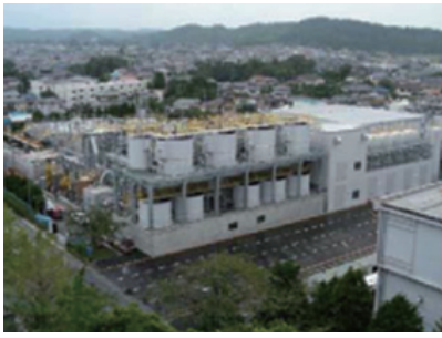
高度水処理システム (IPS アルファテクノロジー)
