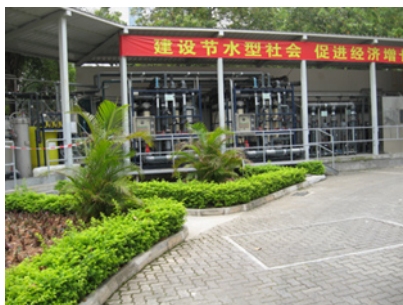
廃水リサイクル設備(2007年深圳市水道局モデル事業)
