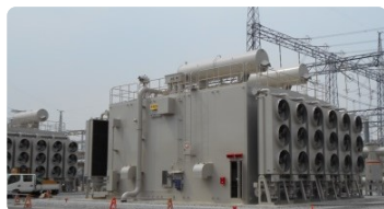
国内変電所 位相調整器納入 (2017年8月)
